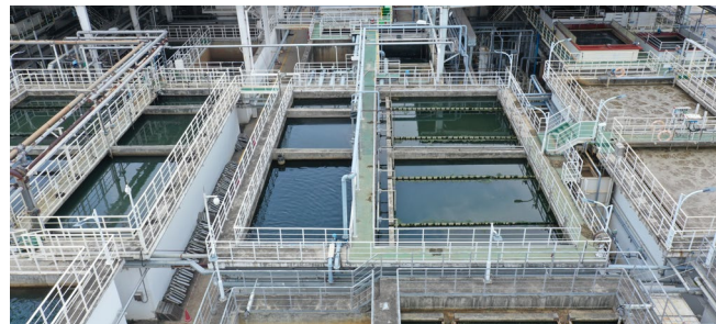
廣汽豐田污水處理站
