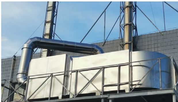
广州安斯泰莫电泳车间气旋塔及双极活性炭吸附处理工艺
