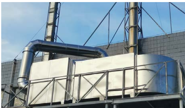
广州安斯泰莫电泳车间气旋塔及双极活性炭吸附处理工艺
