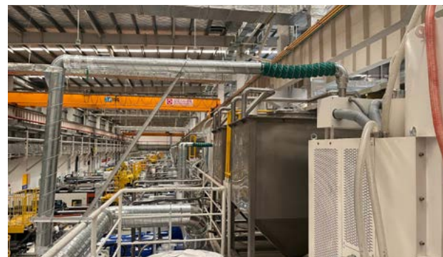
武汉斯坦雷成型车间喷淋塔 + 生物法废气处理设施
